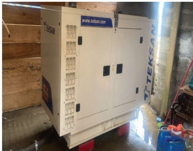
Planta eléctrica adquirida por el Nivel Regional para el Centro de Salud de Carti Sugdup, mayo 2024.
