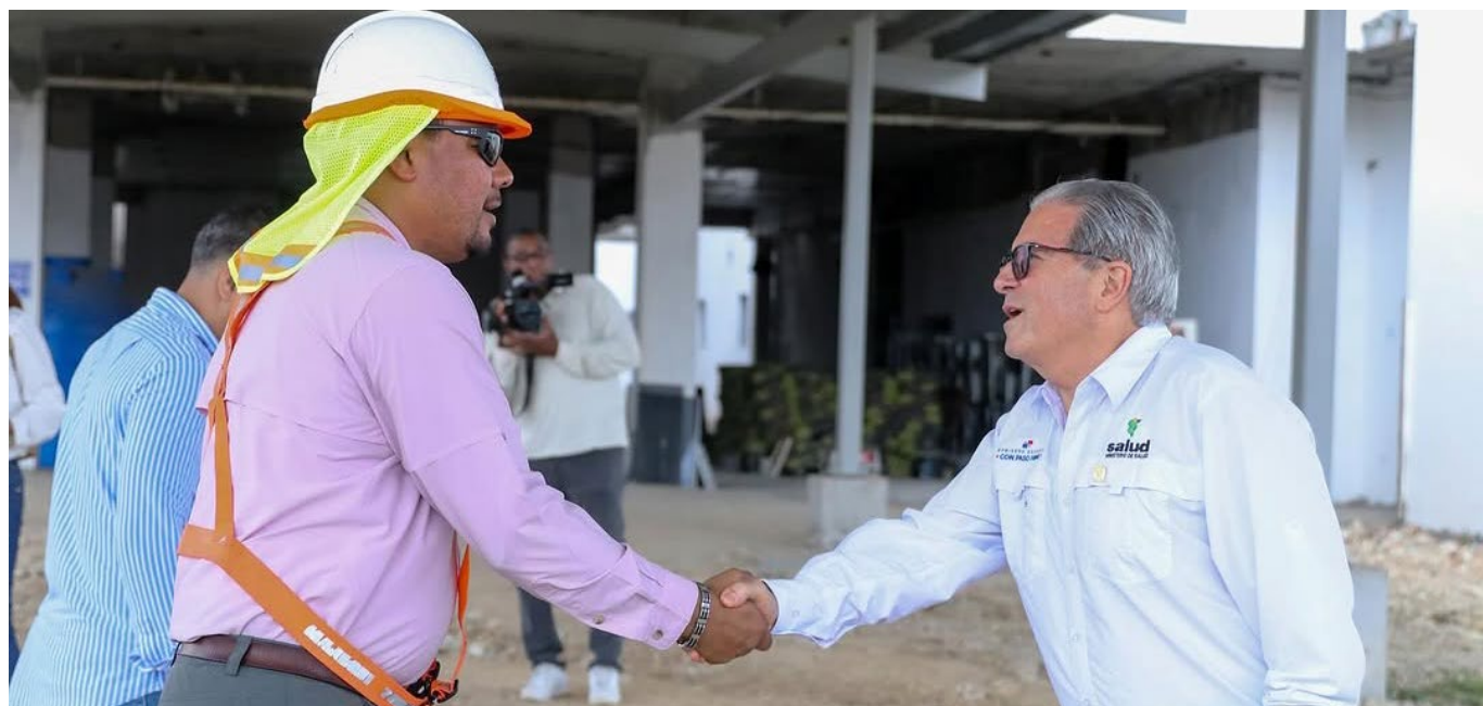
Recorrido de su Excelencia el Ministro Dr. Fernando Boyd Galindo a la construcción del Hospital de Meteti, obra que cuenta con una inversión de B/. 139 millones, que beneficiará a más de 70,000 personas en la provincia de Darién.
