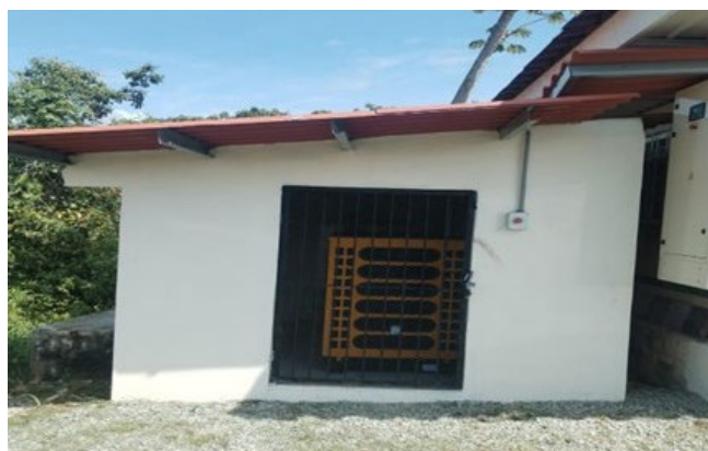
Construcción de la casa planta área del Biológico Regional de Cartí, febrero 2024.
