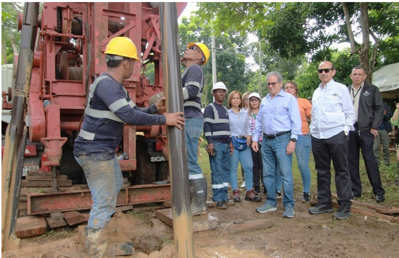
Visita a la construcción del nuevo pozo de agua en El Naranjal, Panamá Este, gracias a las tres perforadoras recién adquiridas. Esta obra beneficiará a más de 800 personas.
